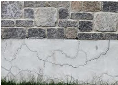
Fissurations au début
